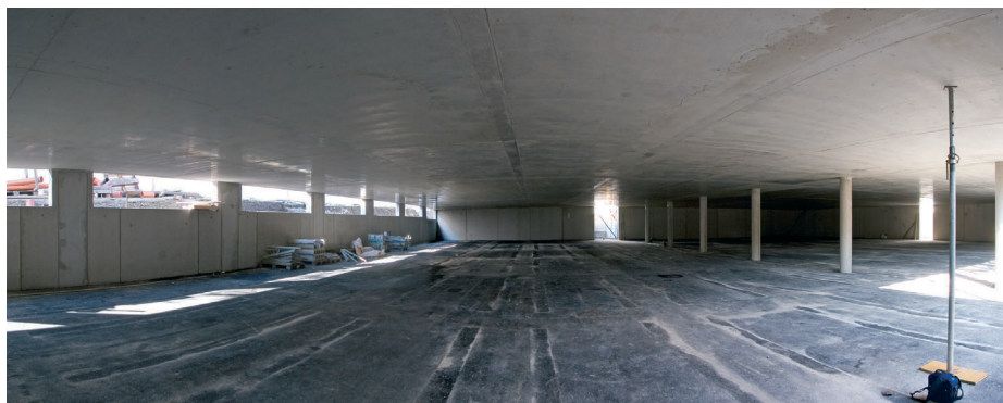
Mit Cobiax-CBCM-eco konnte eine wesentliche Eigengewichtsreduktion der Massivdecke erreicht werden, die von 14 Innenstützen mit einem Durchmesser von 50 Zentimetern getragen wird.
