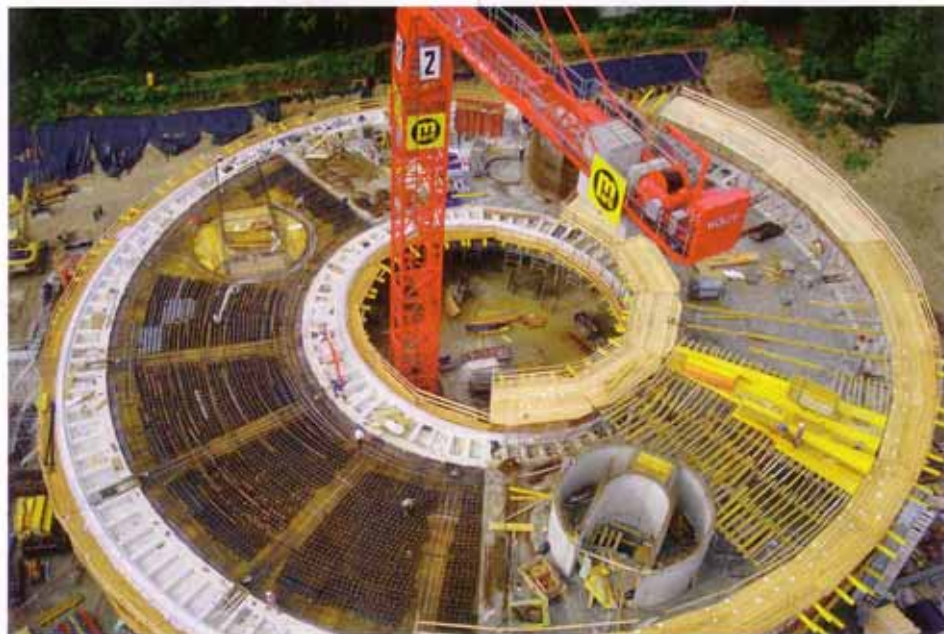
Baustellenfoto: gut erkennbar ist u.a. die innovative Betonkonstruktion mit Cobiax Hohlkörper Technologie
